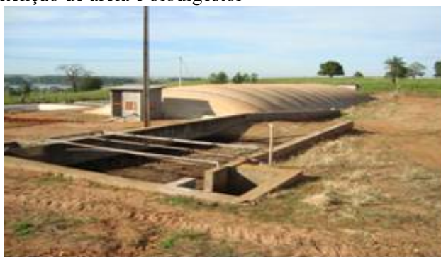
Figura 6 – Caixa de contenção de areia e biodigestor
